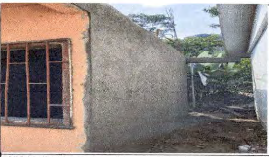
FOTO 11: Repello en muro aula 4
